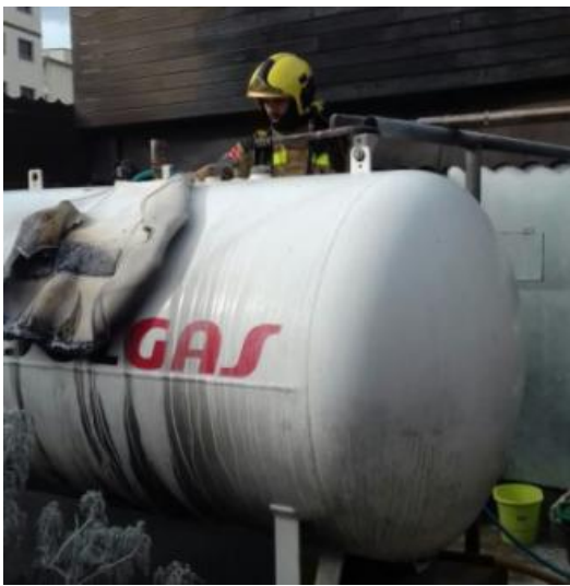
El dipòsit de gas
