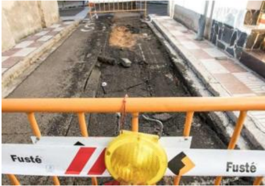
Uns danys en la xarxa d'aigua potable retarden les obres de dos carrers colomencs
