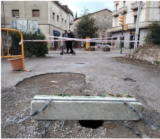
Un altre esvoranc per esfondrament J.C.
