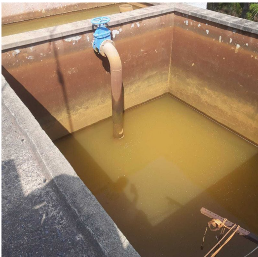
Una de les imatges de l'estat actual de les instal·lacions que els veïns han fet arribar a l'Ajuntament EPA.
