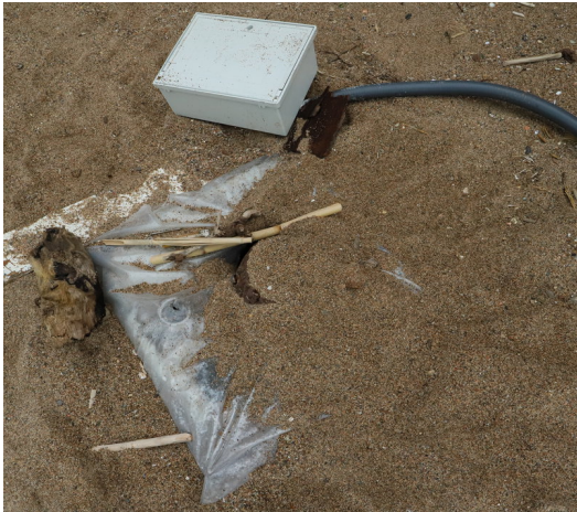
La "fossa sèptica" i tubs al descobert per la llevantada, que el consistori diu que duen l'aigua bruta a depurar E.A.
