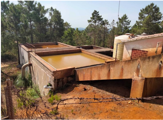
Captació de l'aigua a Residencial Park. Planta potabilitzadora. JORDI CASAS.
