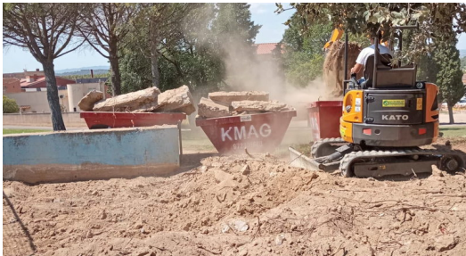
Maquinària al solar on s'està fent la millora d'accessibilitat AJUNTAMENT DE TORROELLA.
