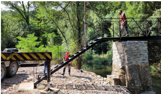
L'escala per pujar a la passarel·la, durant els treballs de reconstrucció AJ. SANT JOAN LES FONTS.
