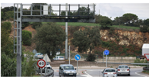
El pòrtic cremat del radar de tram de Cassà –a la sortida sud del poble– que té inutilitzat el control fins a Llagostera M. LLADÓ.
