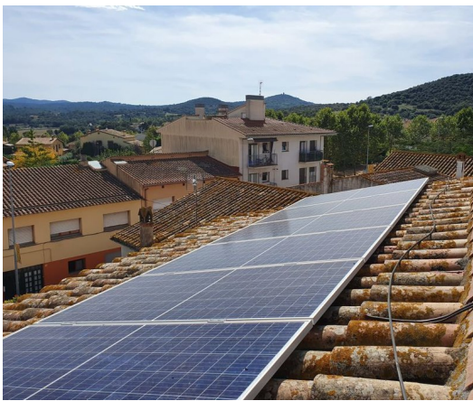
La instal·lació fotovoltaica de la coberta de la casa de la vila AJUNTAMENT DE MAÇANET DE LA SELVA.
