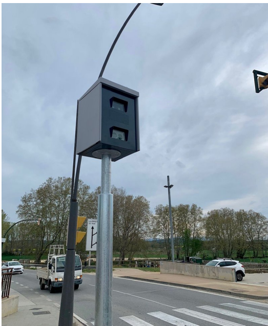
Un dels radars ja instal·lats. AJUNTAMENT DE VIDRERES..
