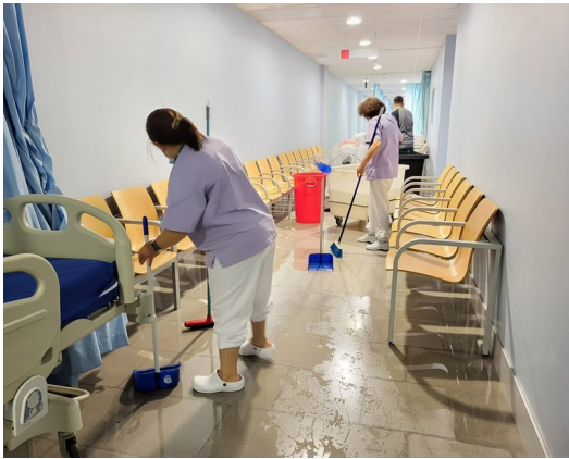
La planta -1 de l'Hospital de Figueres es va inundar FUNDACIÓ SALUT EMPORDÀ.
