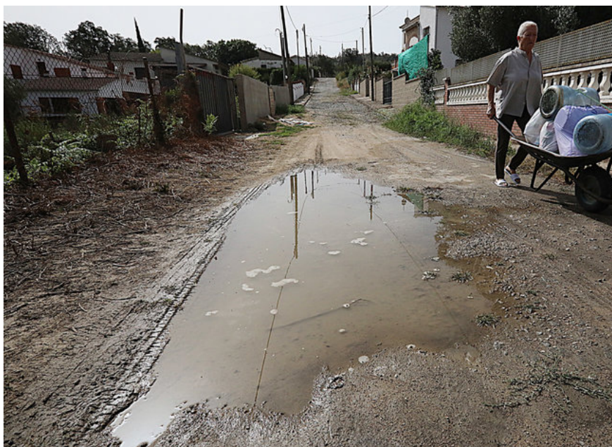
Una veïna de Selva Brava, a Llagostera, tragina un carretó per un camí malmès de la urbanització MANEL LLADÓ.
