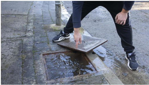
Un veí de Puigventós amb una de les fuites que hi ha a la urbanització.
