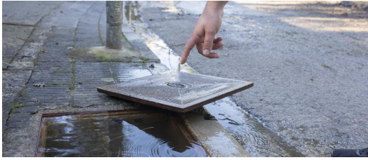
Imatge d'arxiu d'un veí de Puigventós amb una de les fuites que hi ha a la urbanització.
