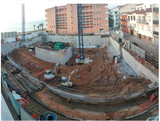
Vista aèria de les obres, amb una de les bombes a la part dreta del solar EPA.
