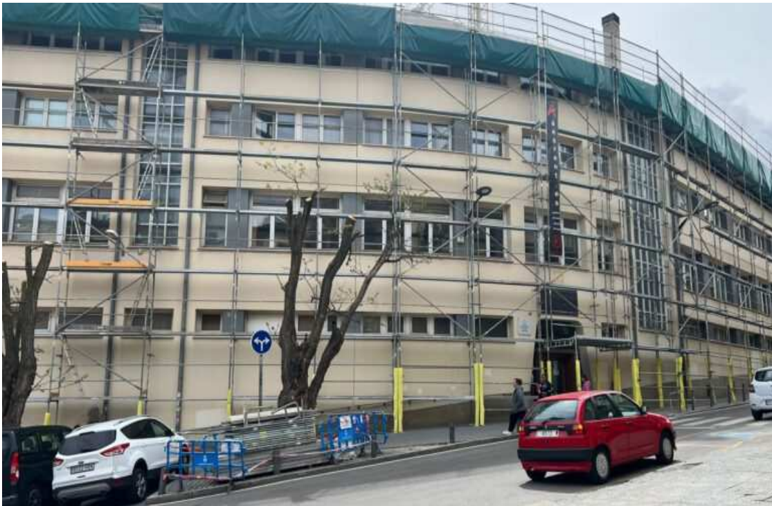
Aspecte exterior de l'Institut mentre es realitza la reforma de la teulada./M.F.
