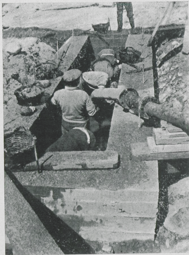
Fonamentació d'una pila del pont sobre la Muga en el camí de Pont de Molins a Les Escaules
