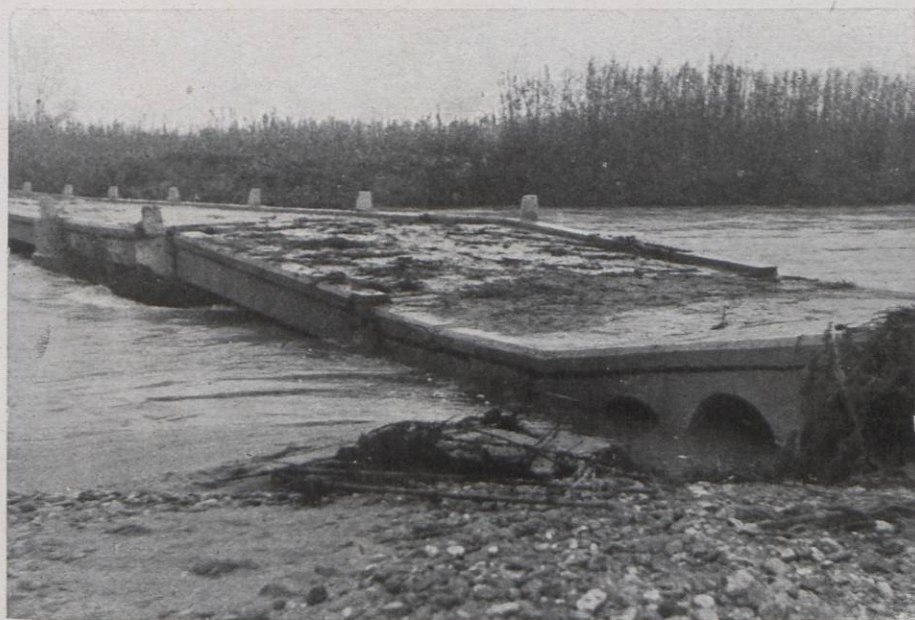
Pont sobre la Muga en el camí de Pont de Molins a Les Escaules. Desperfectes ocasionats per les riudes
