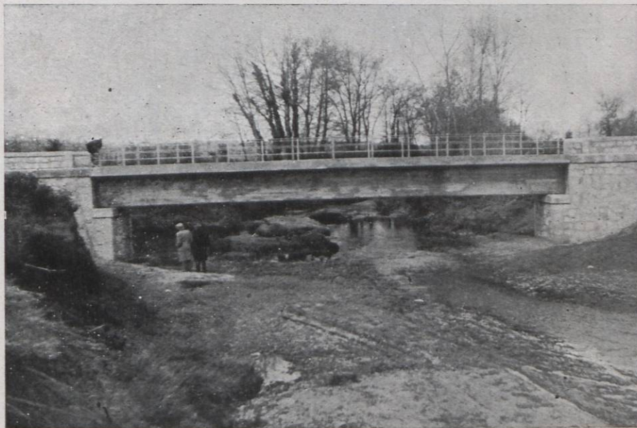
Pont sobre la riera Verneda en el camí de Cassà de la Selva a Caldes de Malavella
