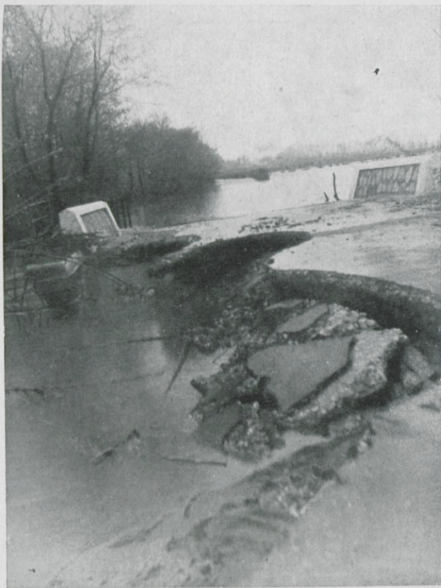
Camí de Figueres a Espolla, inundat per les aigües. Pont retorçidor fet malbé per les inundacions
