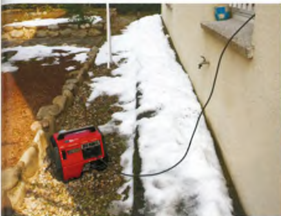
Alguns particulars es van poder proveir d'electricitat a base de generadors.
