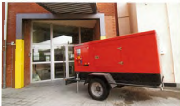
L'Ajuntament va proveir d'un generador el pavelló del CEIP Sant Esteve
