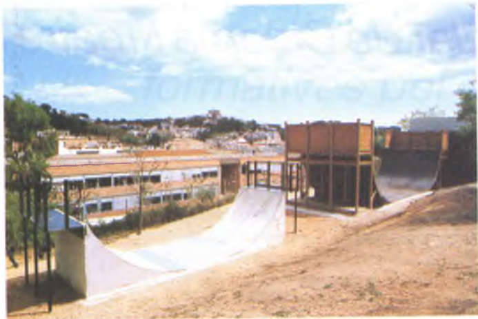
◆ Instal·lació pistes de monopatins Parc de les Eres. Empreses Subministradores: Contener i Tècniques Ambientales. Instal·ladors: Brigada Municipal. Pressupost 2.261.000 Pta
