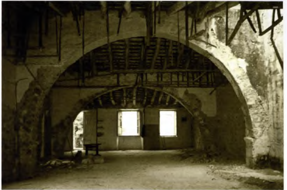
Sala del primer hospital de l'Escala en una foto obtinguda el 1984 en enderrocar-se el vell edifici de l'ajuntament. Es pot contemplar la planta pis amb els arcs que aguanten l'embigat de fusta; l'edifici té volta de canó a la planta baixa. / Foto: Benjamí Bofarull.
