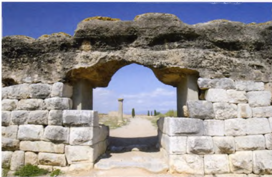
Sector de la porta de la muralla romana meridional desproveïda dels carreus originals que conformaven el seu basament, els quals han estat substituïts per un modern parament destinat a evitar l'esfondrament de les restes esberlades de l'opus caementicium superior. Foto: Dídac Colomeda.
