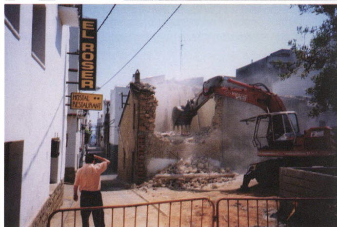
Passat l'estiu del 1998 es va fer l'actual Plaça Nova, al pati de Cal Campaner. En aquestes dues imatges es poden veure les obres d'aleshores. A la superior encara hi ha ca la Mèlia i a can Payet; a la inferior s'estan derruint per tal d'ampliar la pujadeta del carrer Església per poder accedir més bé al pàrquing de la Plaça Nova.
