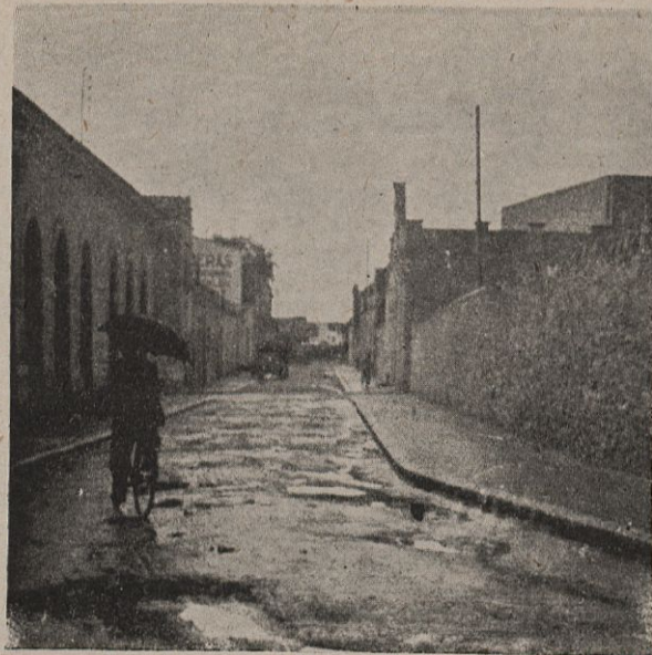
Una calle seguramente sin conducciones subterráneas. El agua está a flote de la calzada. Esta vía urbana, entre las más céntricas y de mayor tránsito de la ciudad de Figueras, se llama calle de MÉNDEZ NÚÑEZ. Su virtud principal, cuando llueve, es la de almacenar agua y más agua y aumentar los cálculos del presupuesto municipal, a cuenta de ir esperando y considerando.
