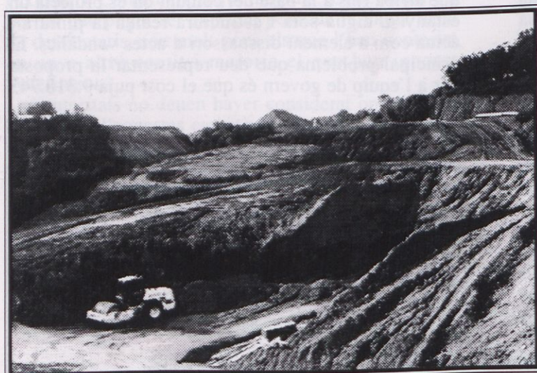
Les obres del desdoblament de la variant, en el tram de la costa d'Alou, continuen a tot ritme.
