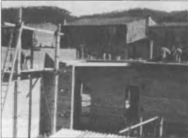
1945-Josep Frigolé Grau. Els paletes d'en Josep Frigolé edificquen el "Cinema Unió" al solar de l'antiga fàbrica tèxtil d'en Font. La fàbrica Gròber en feia el mecenatge. Durant molts anys, els locals d'aquest teatre adaptat al cinema seran la seu de l'associació cultural i esportiva "Alba Bescanonina".
