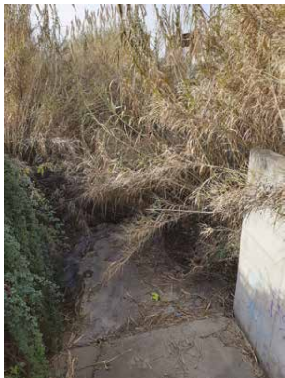
La llera ha fet grans basses a diversos punts i ha erosionat els marges laterals del torrent com es veu aquesta imatge des del c/ Pla de l'Estany.
