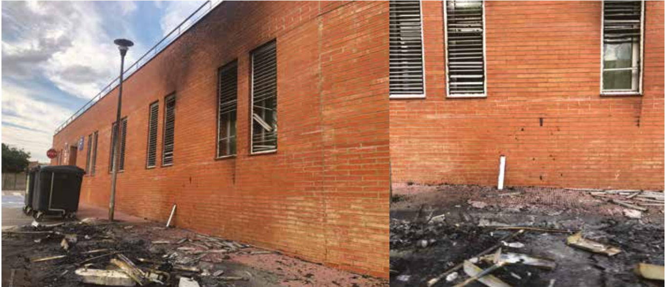
Així van quedar la façana i finestres de la residència geriàtrica després de l'incendi d'un contenidor on van calar foc la nit de Sant Joan.
