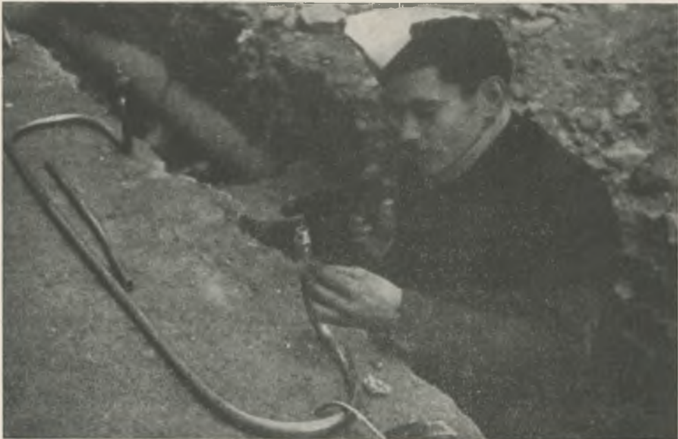
Ya nos parecen viejas estas fotos de la instalación del agua. En verdad, son de ayer. — Foto Pomareda.
