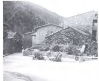
Carrer del Rec, canalització del riu i construcció del mur protector de l'Horf del Capellà.
