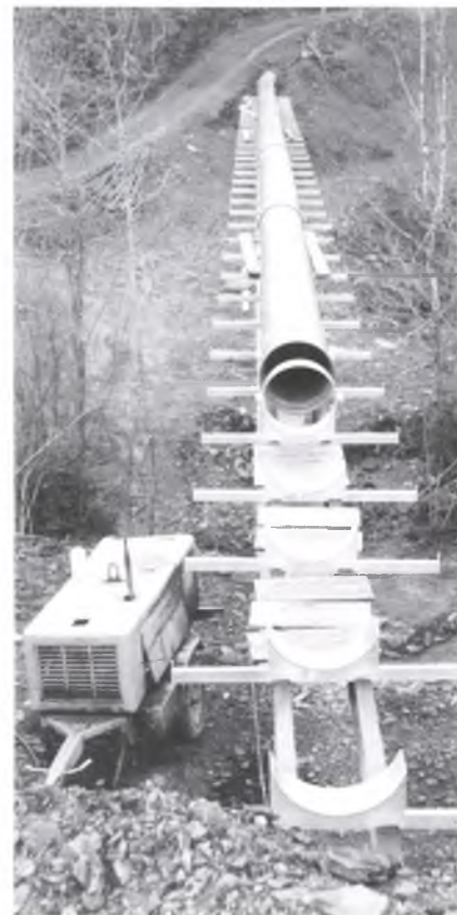
El tub prefabricat que condueix les aigües a la central.
