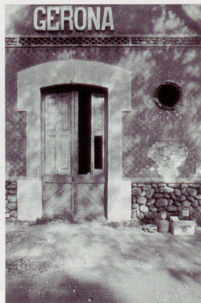
Porta d'accés que donava a la façana de les vies. La decoració simètrica de l'estucat a base de quadres amb una refosa recordant juntes de rajola es trobava en estat deficient.
