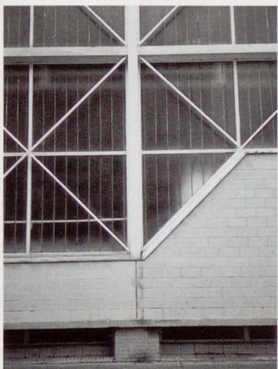
A. Pla, S. Pasarín. Valent constructivisme estructural, tecnològic i de materials. Pavelló del GEiEG. Girona, 1979.
