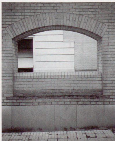
Ll. Clotet, I. Paricio, R. Reixach, G. Barreno. Tecnologia tradicional d'obra vista de perfecta execució. Banc d'Espanya. Girona.
