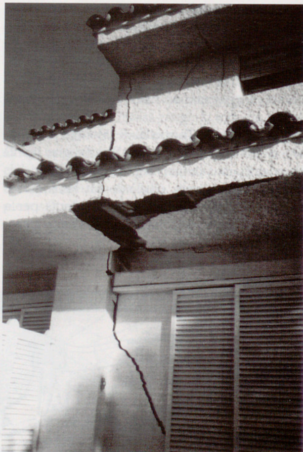
Estat de ruïna progressiva de la casa situada en el sector E-F.
