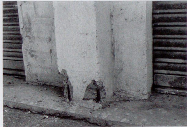
Aspecte d'un element de formigó afectat per la corrosió.
