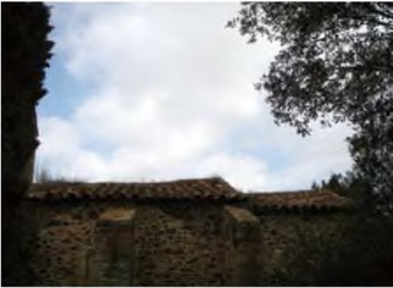
Detall de l'estat del teulat, amb matolls i herbes que creixen entre les teules. Foto: J. Vidal.
