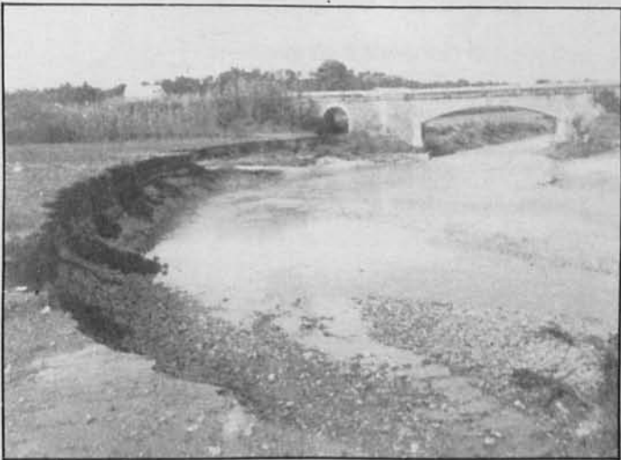
Esllavissades al pont de "l'Empalme" amb les riudades de la tardor del 1970
