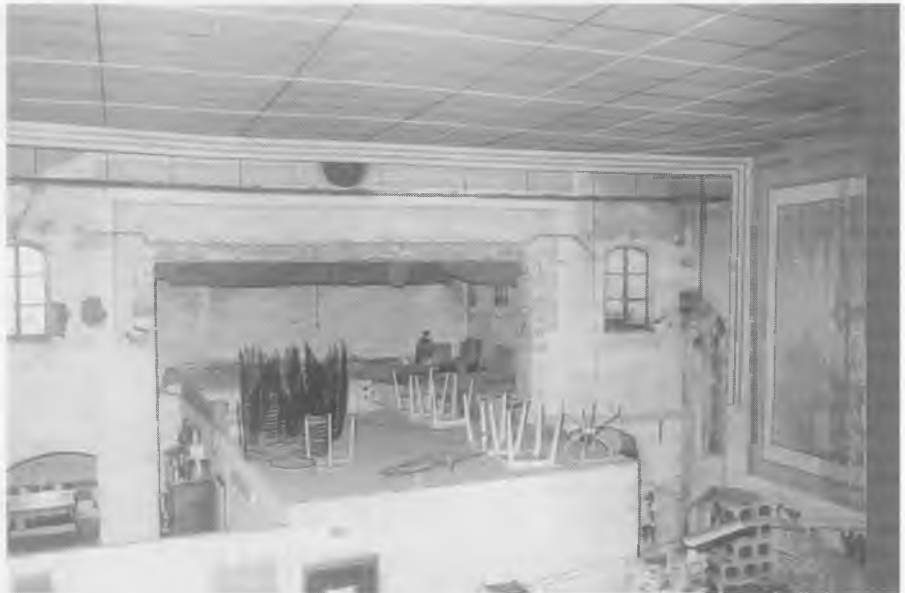
L'antic Cine Rovira a l'actualitat. Encara es pot veure la boca de l'escenari i el suport de la pantalla panoràmica. La resta de la sala avui forma part del complex de l'Hotel Rovira com a magatzem.
