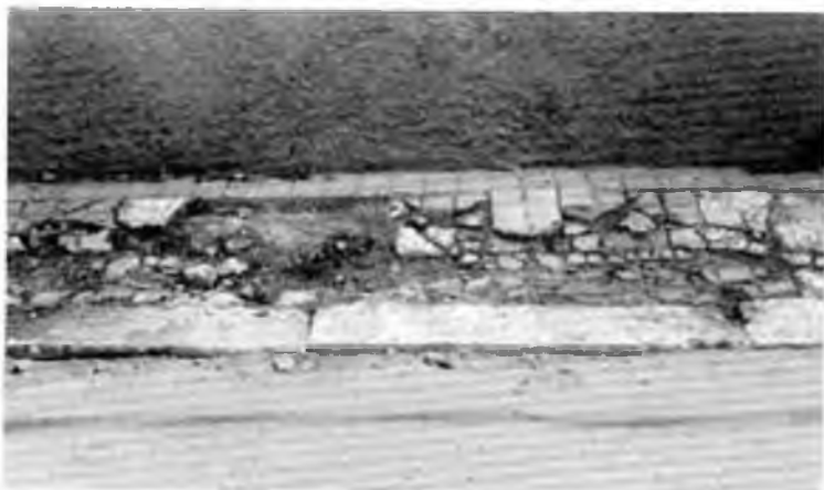
Lamentable estat d'una vorera del carrer Quirze Jordà.
