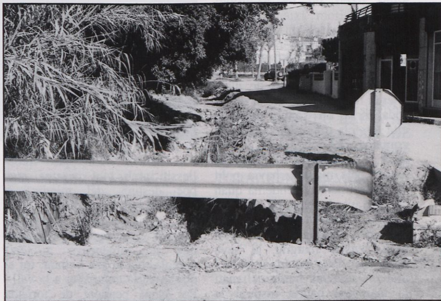
La riera de les Suredes, (o riera de can Pepus) que es va desbordar durant els últims aiguats ocasionant molts problemes als veïns.
