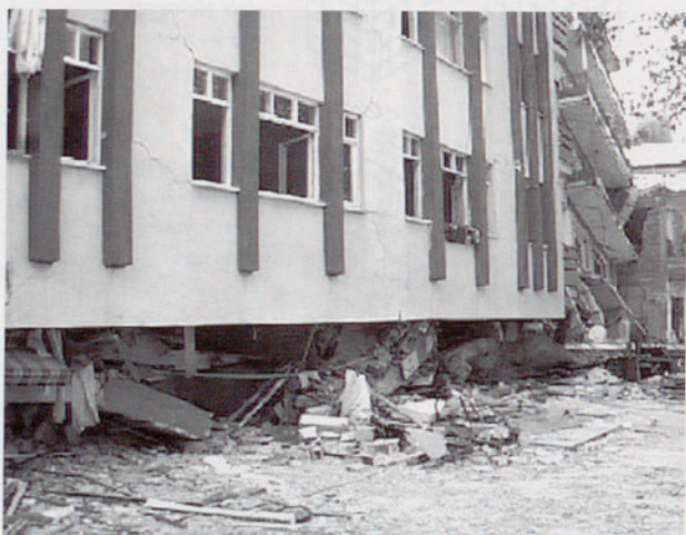
Terratrèmol d'Izmit (Turquia). Ha desaparegut la planta baixa (pis dèbil).
