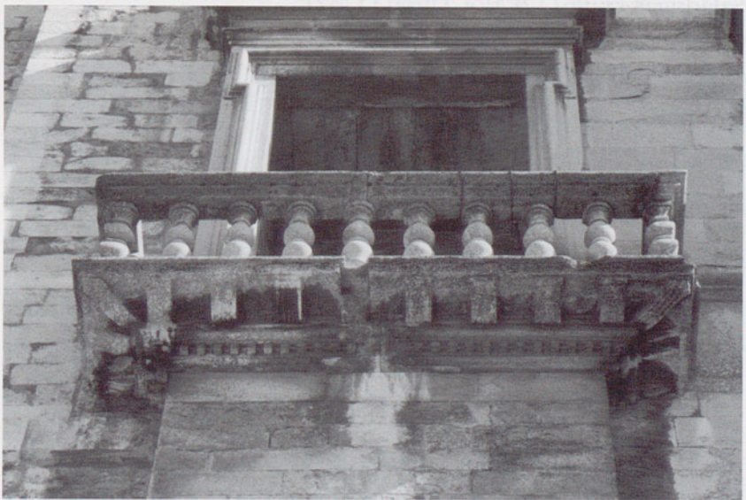
Elements de la façana degradats per l'aigua.
