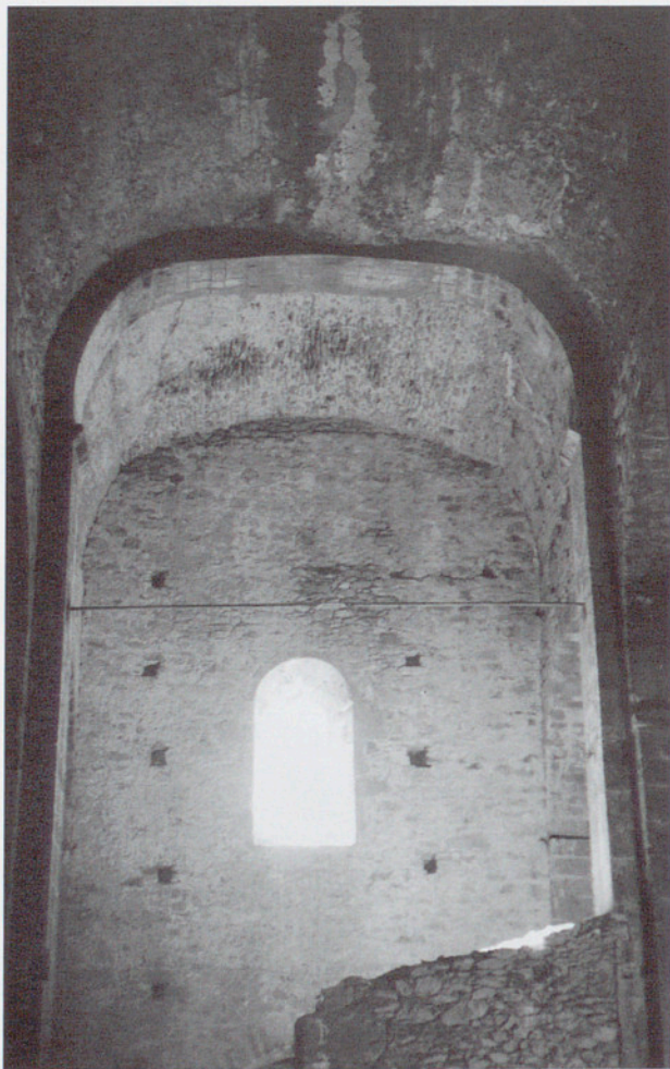
El sector occidental de la volta de la nau central de l'església de Sant Quirze ha sofert una marcada degradació.
