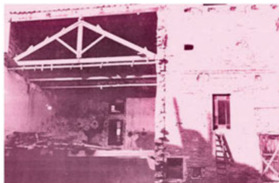
La imatge de les obres de construcció de l'actual Teatre Centre ens permet observar les reduïdes dimensions de l'antiga sala.
