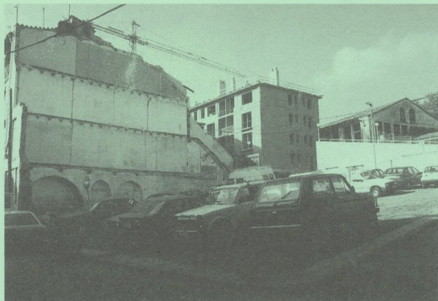
En primer terme: enderroc Plaça Camp d'en Mas. En segon terme: nova construcció del c. Esglaiers.
