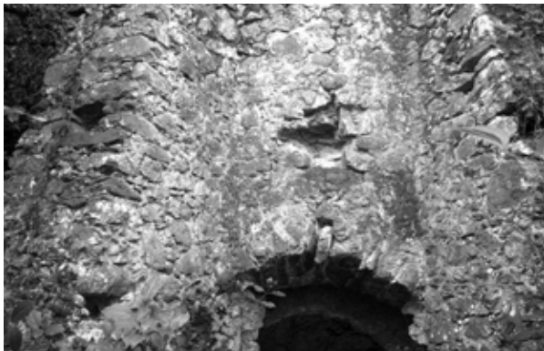
Estructura que conforma el Forn de Ca l'Obert 2 (Madremanya). Autor: Jaume Badias.
