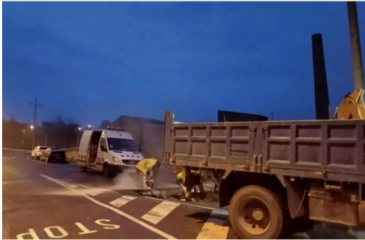
Una avaria a la canonada principal deixa la Bisbal sense aigua a la nit.
