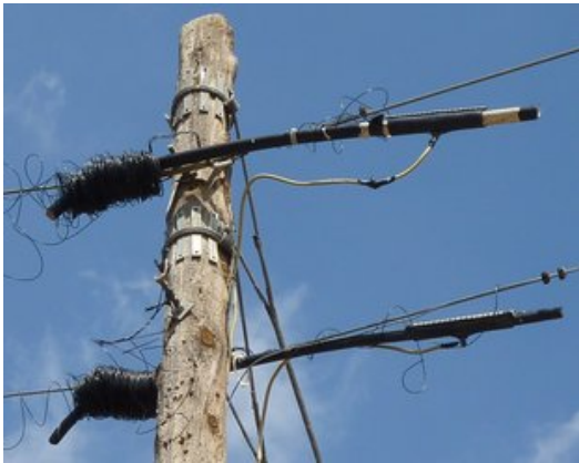
Els lladres tallen els cables de coure dels pals telefònics i se l'enduen a trossos Foto: Ò. PINILLA.
