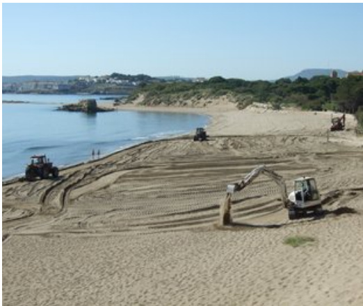
Les màquines treballant a les platges de l'Escala, afectades pels temporals. Foto: EL PUNT.
