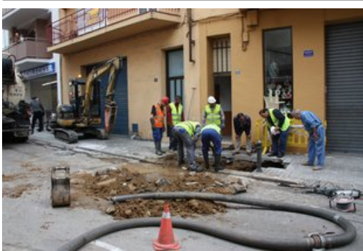
Els tècnics intenten reforçar l'estructura de sota la vorera perquè l'edifici no cedeixi Foto: ACN.
