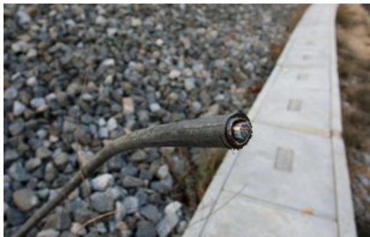
Un dels cables que els delinqüents van serrar. Es tracta d'un tub que uneix Barcelona amb Girona Foto: EL PUNT AVUI.
