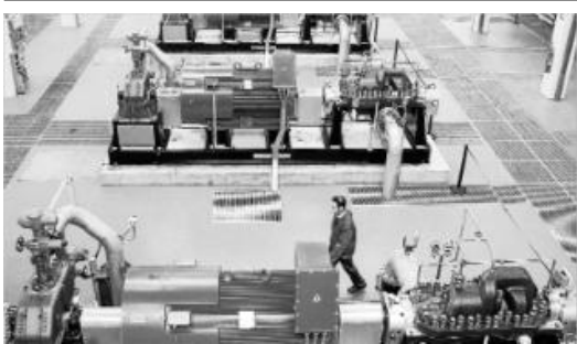
Un treballador de la dessalinitzadora de Blanes, que està aturada des del novembre, en una imatge d'arxiu.<br/>
