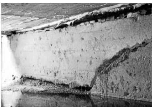
Alguns dels desperfectes detectats a l'interior de la riera al novembre.
